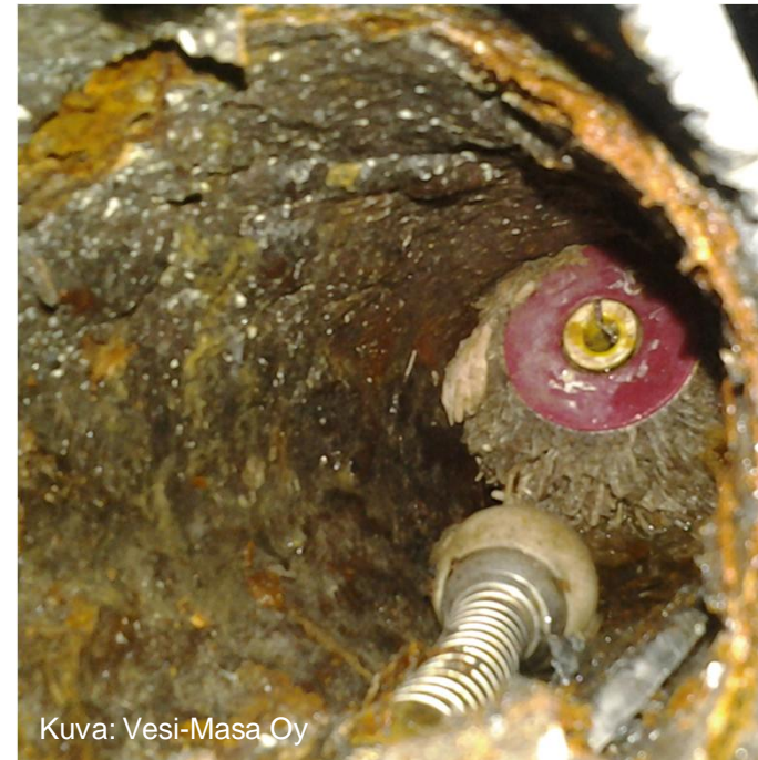
Kuva: Vesi-Masa Oy Maalitelan aiheuttama viemäritukos kerrostalossa
